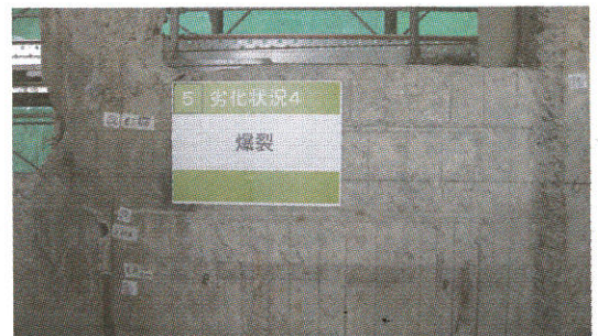
▲見学会では12カ所で劣化や改修の状況を展示
